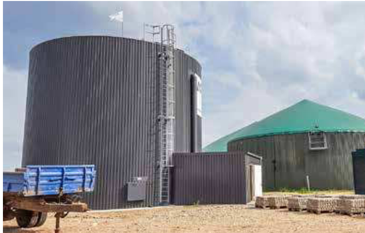
Der mit Wasser gefüllte Stahltank nimmt überschüssige Wärme auf und speichert sie, bis sie wieder gebraucht wird.
