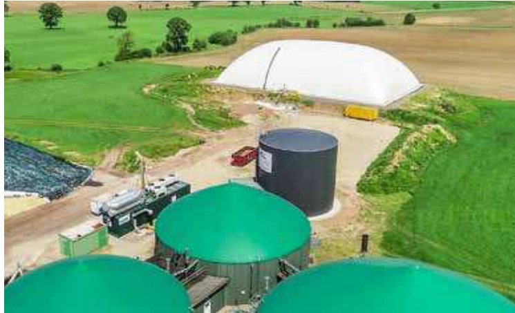
Die Biogasanlage aus der Vogelperspektive – nicht zu übersehen ist der weiße Gasspeicher hinten, davor der neue Wärmespeicher, links neben den Behältern steht das neue große BHKW mit Trafostation. Foto: asl
